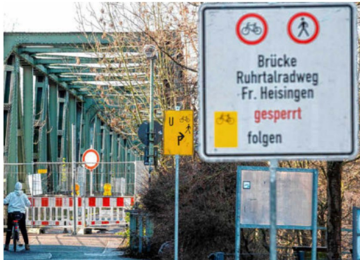
Die frühere Eisenbahnbrücke am Baldeneysee ist seit dem 23. Januar 2026 gesperrt.
